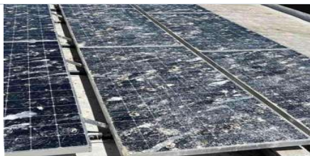
sujidade e deposição de aves em painéis solares
